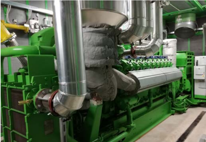
Dettaglio tecnico dell'impianto di Trigenerazione
