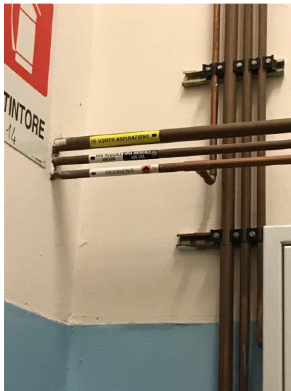
I tubi di rame in arrivo al quadro
