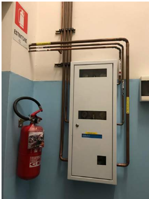
Un quadro di secondo stadio
